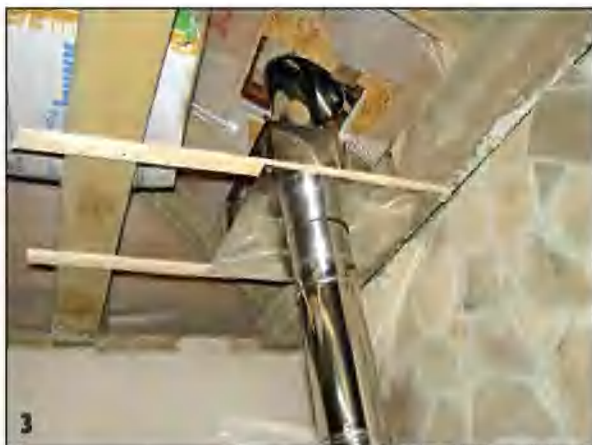
В проходах металлической трубы через потолок...
