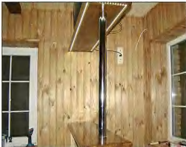
По нижней стороне полки над барной стойкой смонтирована светодиодная лента.
