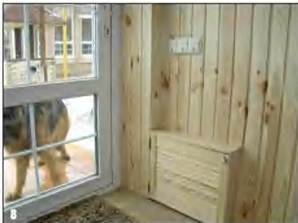
Шкафчик ввода коммуникаций.
